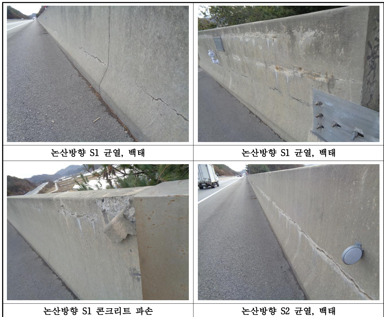
【사진 3.48】 난간 및 연석 손상현황
