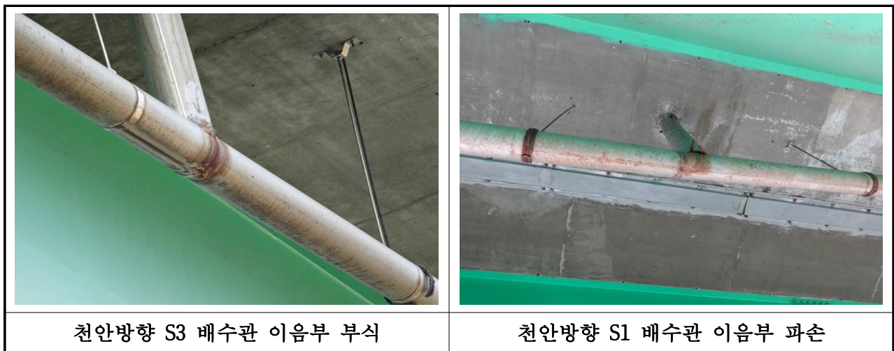
【사진 3.23】 배수관 손상현황
