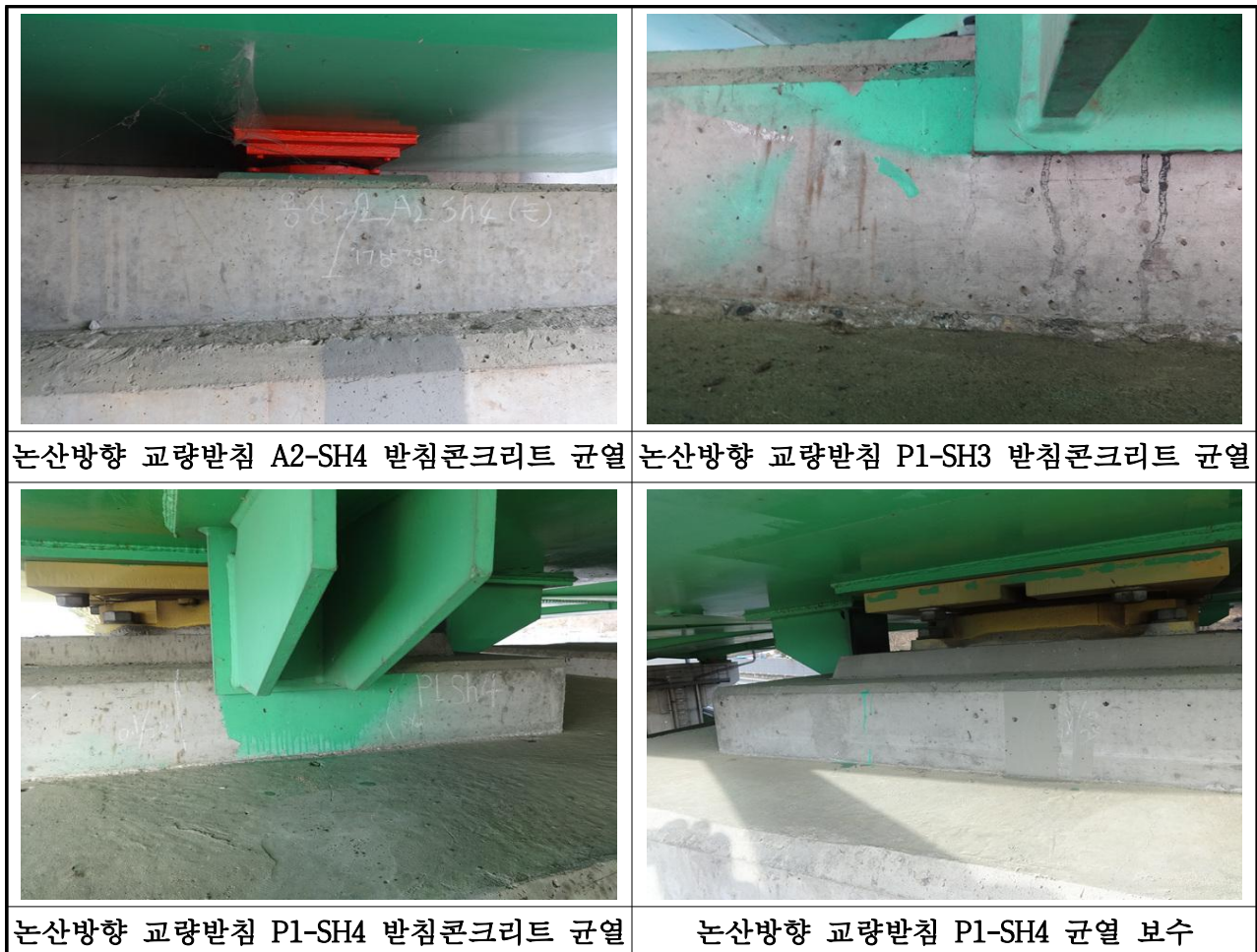
【사진 3.37】 교량받침 손상현황
